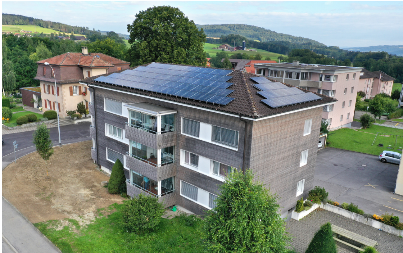
Nach der umfassenden energetischen Sanierung und der Installation von Photovoltaik-Modulen auf dem Dach ist das über fünfzigjährige Mehrfamilienhaus Schützelfeld 1 wieder fit für die Zukunft. Bild: alsona ag – Energiekonzepte und Solar (8. 2021)
