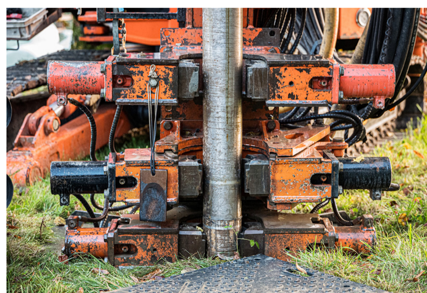
Erdwärme – die umweltfreundliche Energie der Mutter Erde. Mit Bohrungen bis in mehrere Hundert Meter Tiefe und mittels Erdsonden lässt sich die unbegrenzte Energiequelle erschliessen und nutzbar machen. Die Korporation Beromünster verwendet sie kombiniert mit Photovoltaik-Anlagen, wie im Schützelfeld 1. «O'zapft is!»
